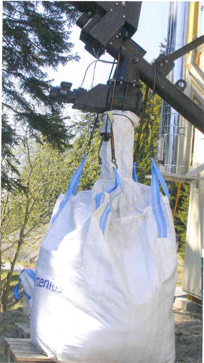
Orifice pour la conduite qui déversera les pellets du silo dans la chaudière.
